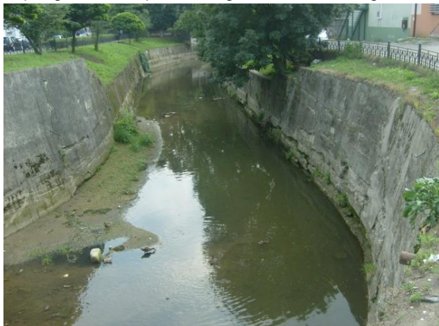
Fot.4. Betonowe koryto, Wątok, ul. Nadbrzeżna Dolna
